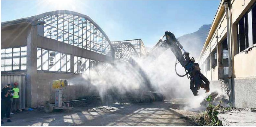
Qui sopra il primo colpo di ruspa alla ex Marangoni Meccanica, qui sotto, da sinistra, Hager, Signoretti, Valduga e l'assessore Tomazzoni (foto servizio Festi)
